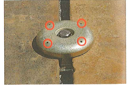
3.各々の敷鉄板にピンが2個ずつ噛んでいるか必ず確認してください。
