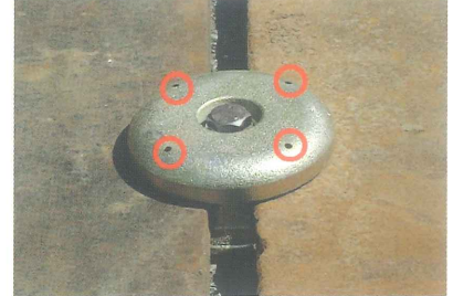
3.各々の敷鉄板にピンが2個ずつ噛んでいるか必ず確認してください。
